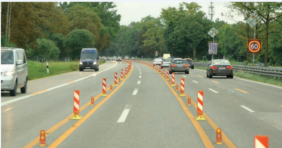
Bild 4: Befahren des Wechselfahrstreifens. Der Wechselfahrstreifen ist durch eine regelkonforme doppelte Gelbmarkierung mit TL-Sichtzeichen ausgeführt worden. Zusätzlich wurde jedes 2. Sichtzeichen gegen 70 cm hohe Bakern zur besseren Sichtbarkeit ausgetauscht. Eine Trennung ohne durchgehende transportable Schutz-einrichtung ermöglicht bei Unfällen oder Pannen eine gute Erreichbarkeit durch den Rettungs- oder Betriebs-dienst. Zur Steigerung der Verkehrssicherheit im 5+0-Betrieb wird die zulässige Höchstgeschwindigkeit auf 60 km/h festgelegt. In regelkonformen Abständen werden die Geschwindigkeit und die Fahrstreifenaufteilung über mobile LED-Anzeigequerschnitte angezeigt
