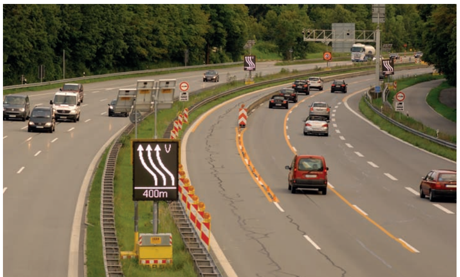
Bild 2: Fahrstreifen zur Weiche geöffnet. In der Spitzenstunde wird für die erforderliche Fahrtrichtung der Fahrstreifeneinzug aufgehoben. Die Leitbaken werden an den Fahrbahnrand gezogen und die Absperrschranke und der Blinkpfeil abgebaut. Somit steht der 3. Fahrstreifen für diese Fahrtrichtung zur Verfügung. Zur Abgrenzung der Fahrstreifen wurden im Einfahrbereich transportable Schutzzeine aufgestellt
