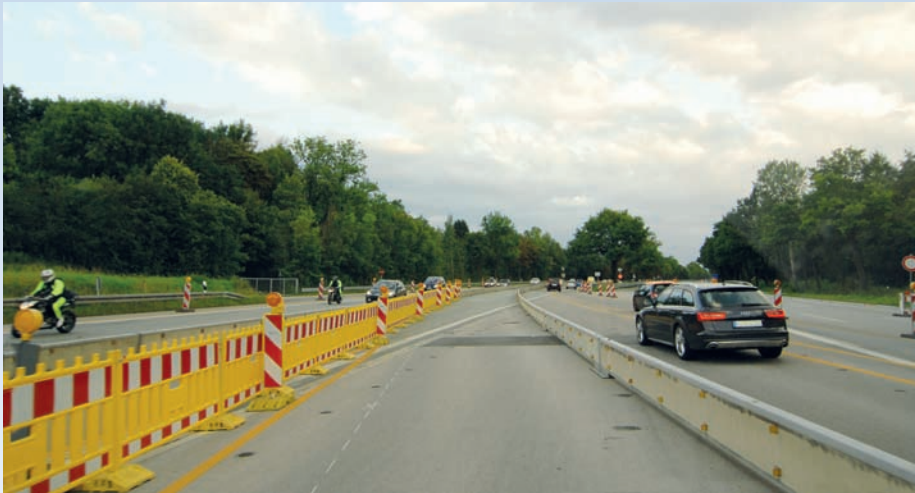
Bild 3: Weiche (Nord) in FR GAP geöffnet zur Einfahrt in den Wechselfahrstreifen. Herzstück der Verkehrs-führung ist die Weiche im Bereich der Mittelstreifenüberfahrt. Diese wird regelkonform durch Leitbaken gekenn-zeichnet. Zur Verdeutlichung wird hinter den Bakern ein durchgehender Arbeitsstellenzaun mit 160° Retroreflexi-on aufgebaut. Durch die leitende Wirkung des geschlossenen Zauns bei Tag und bei Nacht werden Falschfahrer vermieden. Je nach Betriebszustand der Wechselverkehrs-führung werden die Bakern und der Zaun umgebaut
